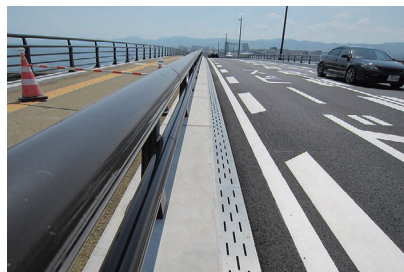
ステンレス鋼製排水溝(黎明みなと大橋)
