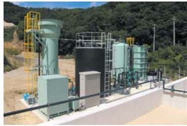
生物接触ろ過方式と晶析法を併用した水処理プラント
