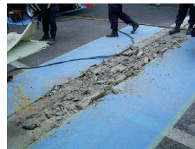
高速道路伸縮部の破碎
